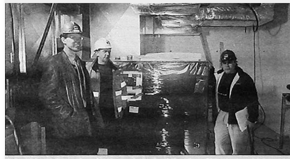
Anleggsleiar Kjell Haavelmoen (midten), adm. banksjef Knut Oscar Fleten (t.v.) og rådgjevar, sivilingeniør Jan Svenkerud ved varmepumpe i teknisk rom.
